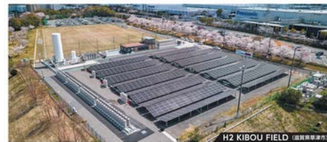
Panasonic 純水素型燃料電池実証施設 出典：Panasonic PRより
