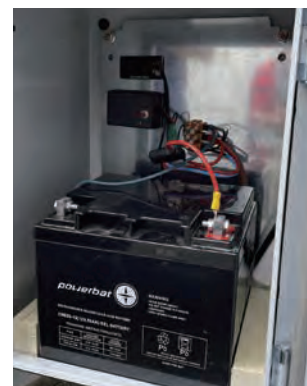
照明用パワーユニット
